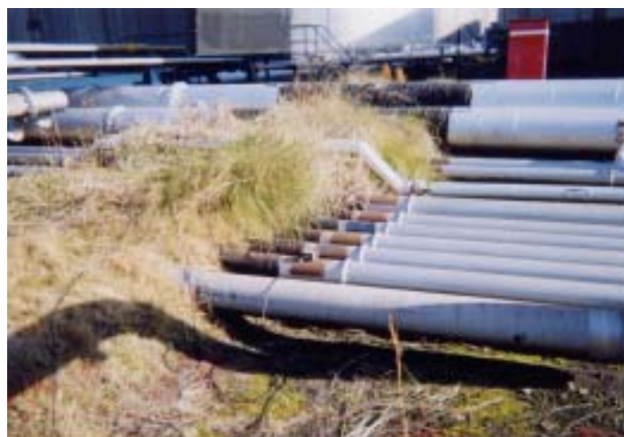
写真3. AE計測を実施した製油所の配管
